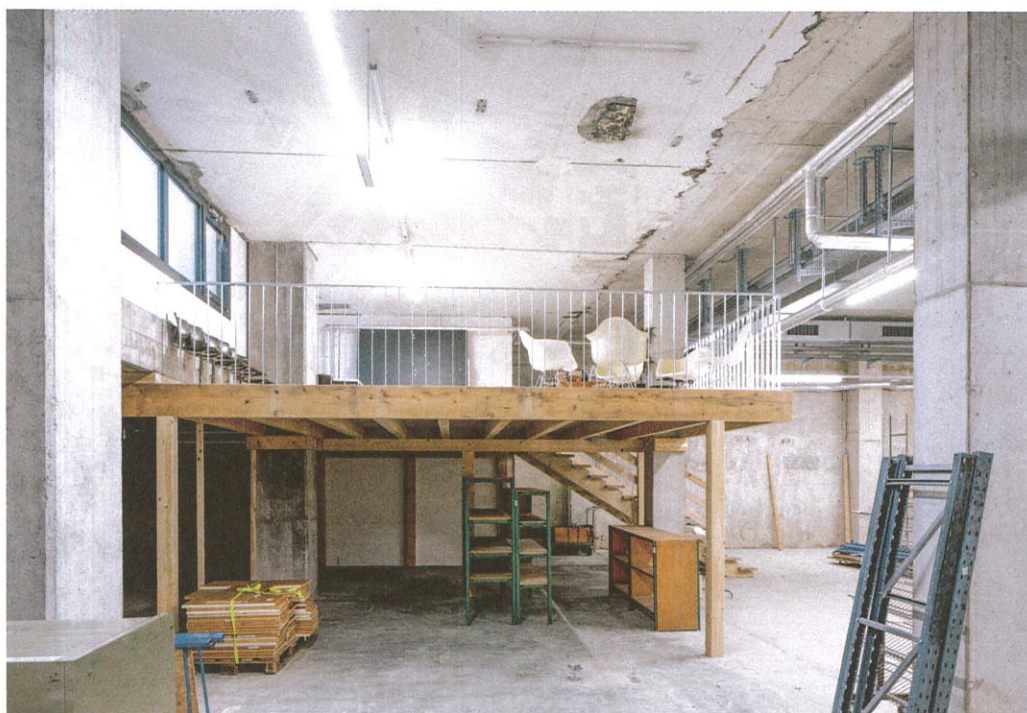
Bis zu vierzig Meter breite und halb im Hang vergrabene Untergeschosse dienen als günstige Gewerbeflächen.
